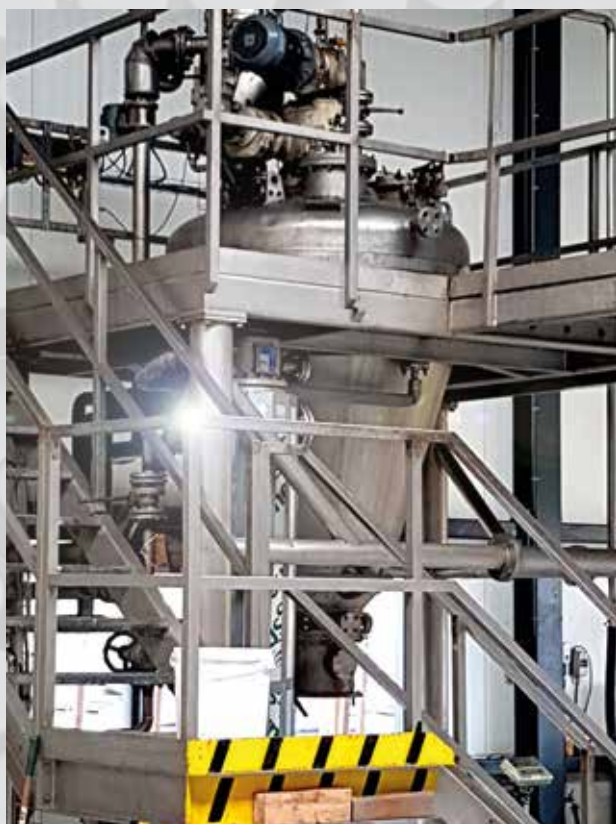
Eén van de mengmachines die de verschillende soorten zouten en toevoegingen vermengen.
